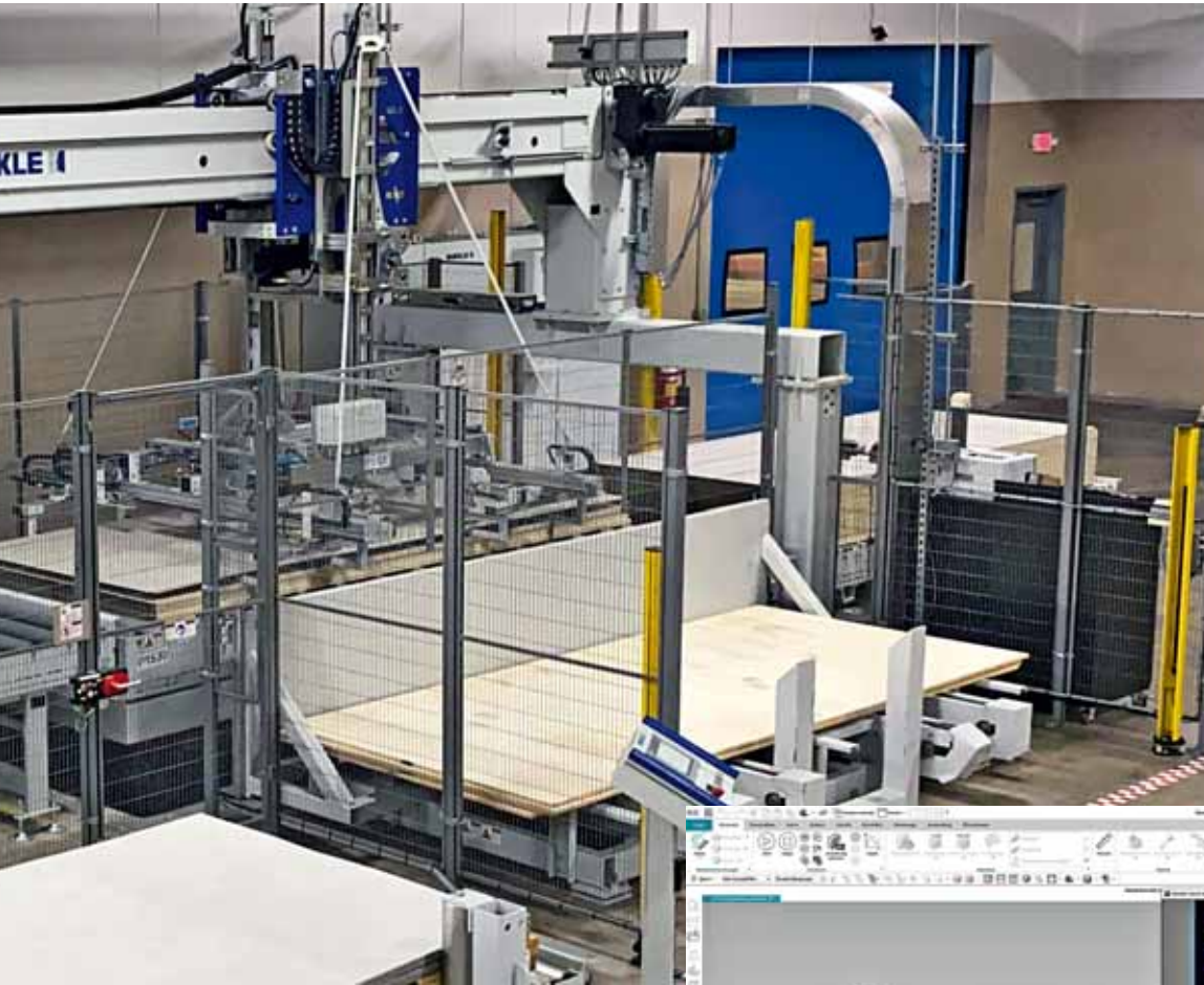
Nach erfolgter Installation und Inbetriebnahme. Seitenansicht Platten-Abstapelung mit Schonplatten-Einzug (Mitte) und Ausfahr-Position der fertigen Stapel (hinten verdeckt), Platten im Durchlauf
